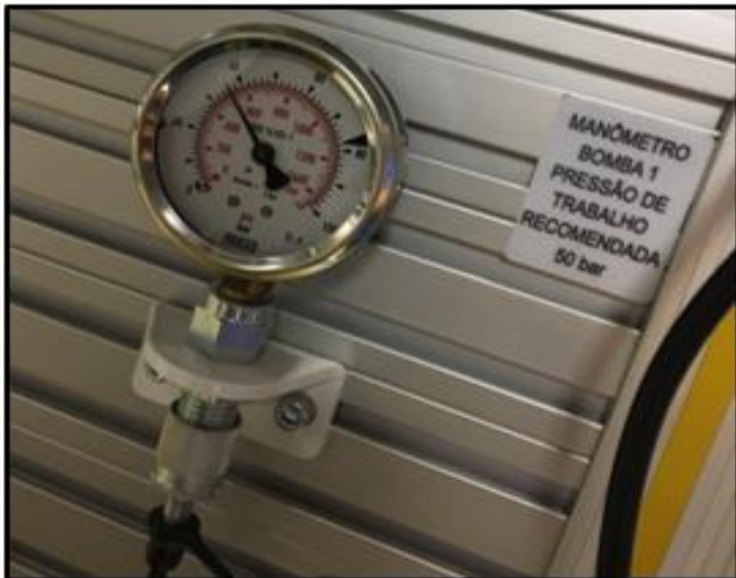
Figura 4- Manômetro utilizado no ensaio de pressão.
